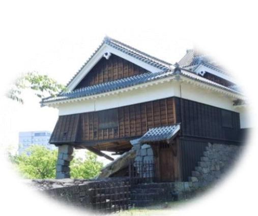
崩落寸前の飯田丸5階楼
